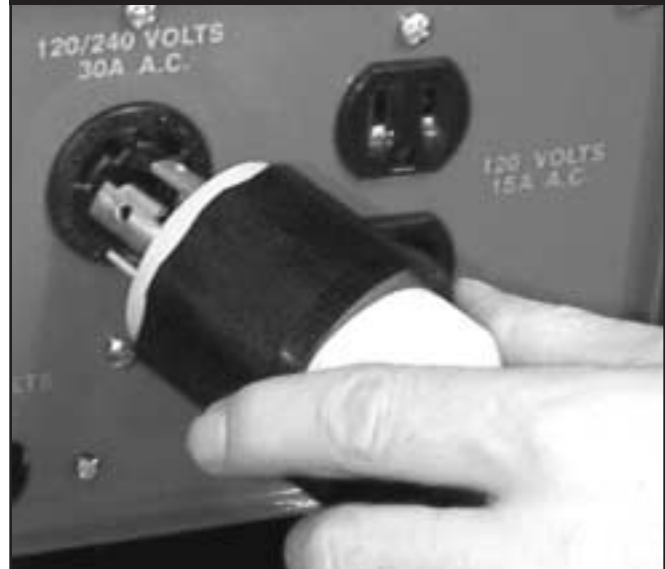
Figure 48 — Alignement des Connecteurs au Niveau de la Génératrice
